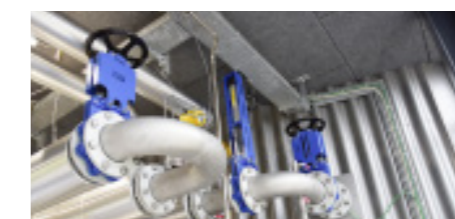
I rådnetanken recirkuleres slammet gennem en varmeveksler.
